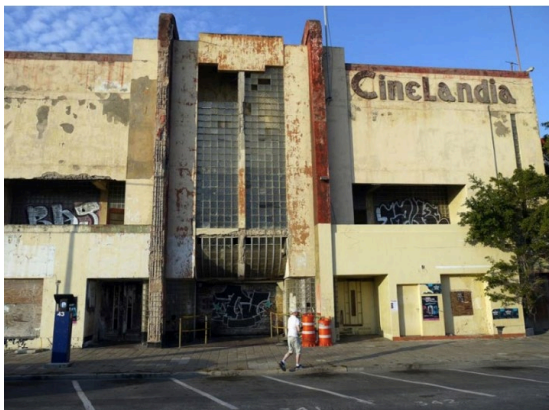
Figure 3.4 – Decay to Cinelandia building in Punda (“MoU voor renovatie Cinelandia”, 13-06-2016)
